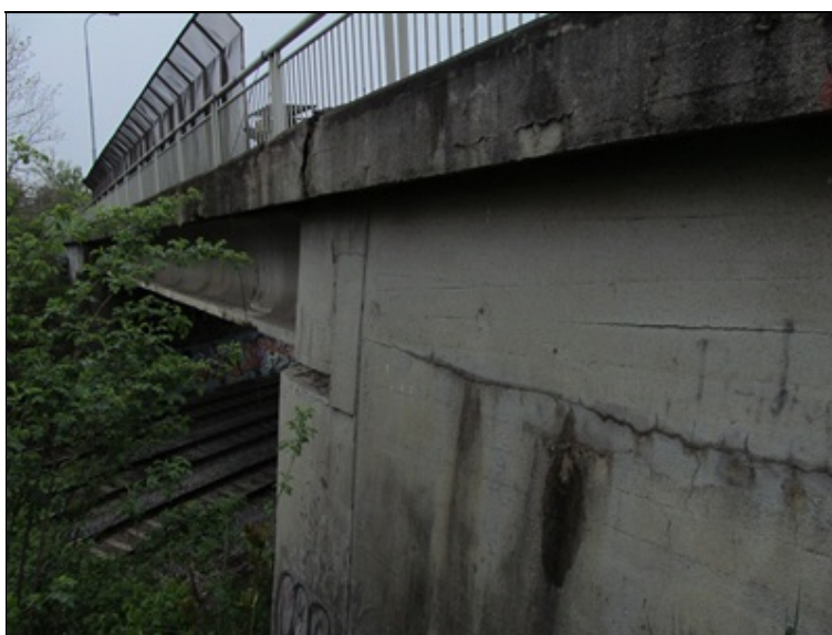
Pohled na levé křídlo O1, vodorovná trhlina s projevy zatékání.
