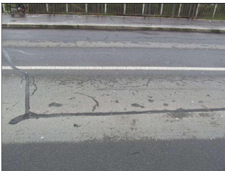
Systém trhlin v povrchu vozovky.
