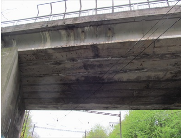
Spodní líc NK, pohled od O2. Zatékání pod římsu mostu.
