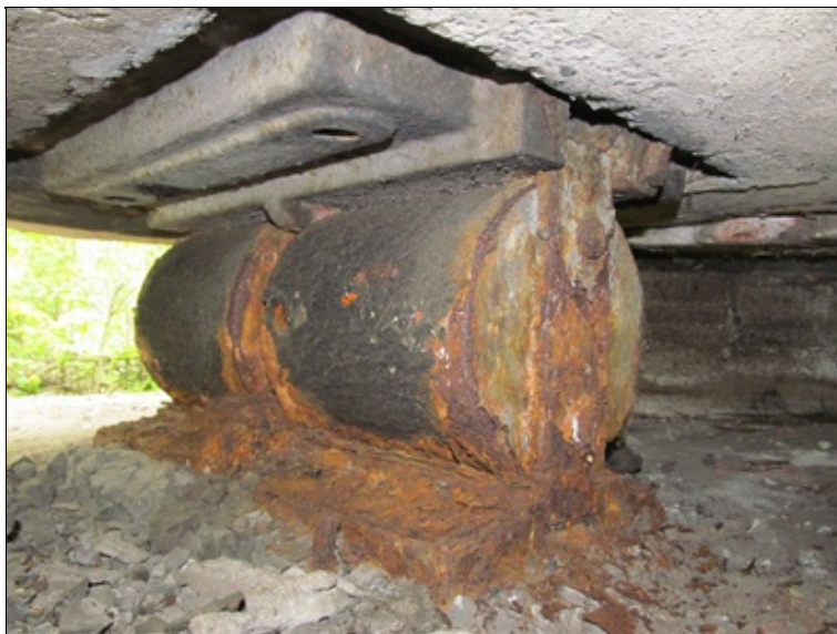
Hlubková koroze krajního ložiska pod N8.
