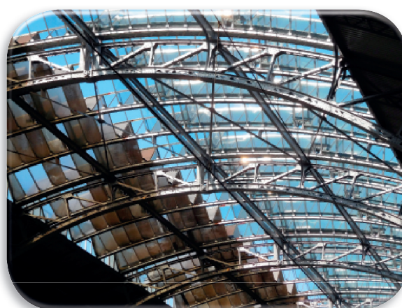
Původní a opravená část zastřešení haly hlavního nádraží
